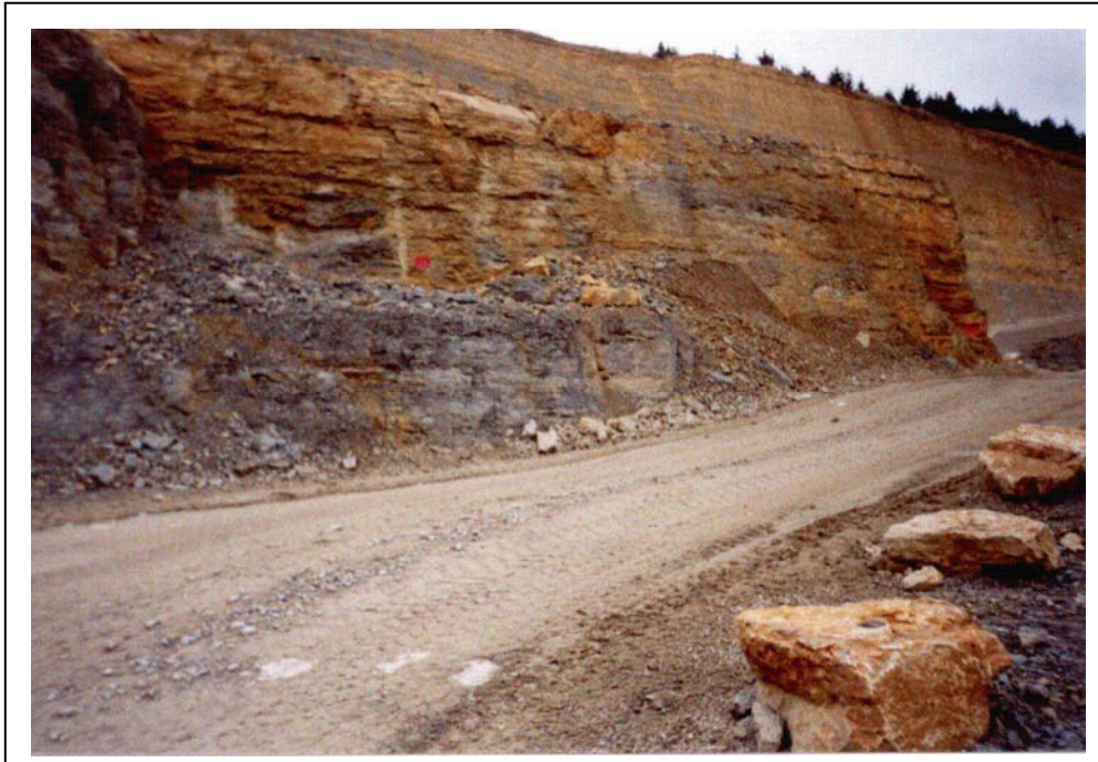
Bild 40: stark klüftiges frostempfindliches Material (Eigenaufnahme 11/00)
