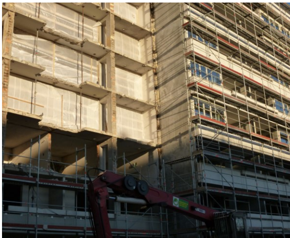
37 Das Baustellenfoto im Tscharnergut von 2014 zeigt eine Raumschichterweiterung um drei Meter sowie das Anbringen einer neuen Fassade analog der ursprünglichen.
