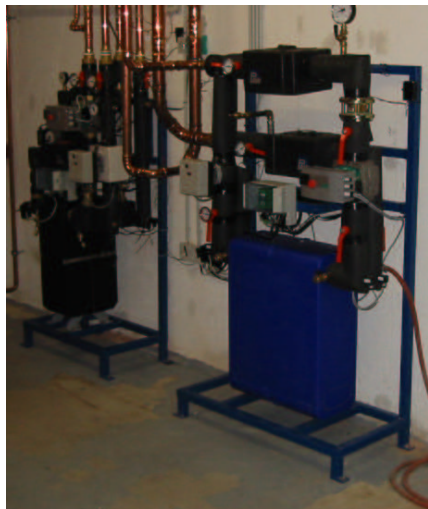
Abbildung 5: Kompakteinheiten mit integrierten vernetzten Emedded Systems
