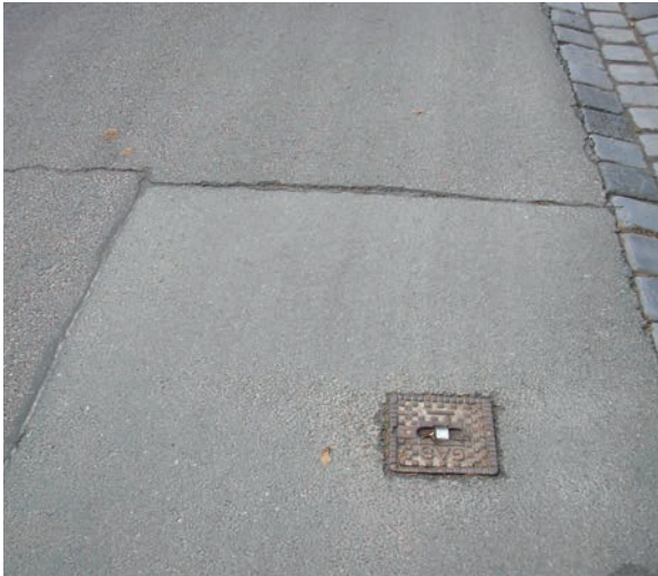
Abb. 4.102: Straßenschäden mit Rissen in den Ecken bei rechteckigem Aushub
