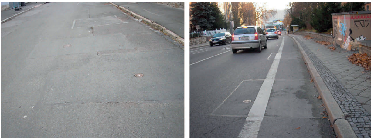
Abb. 4.101: Bitumendecke Weimar (trotz Fugenband Riss und Setzungen)
