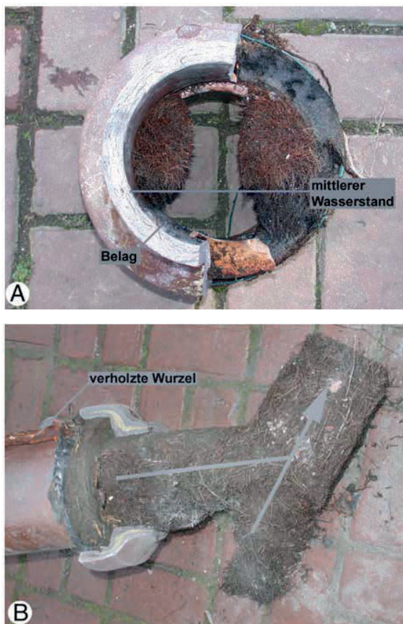
Abb. 7.4: Wurzeleinwuchs in Schmutz- und Regenwasserkanäle [Stützel et al., 2004]
