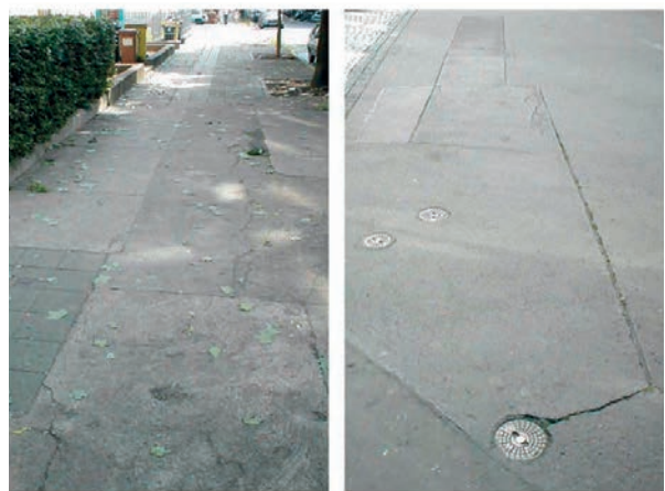
Abb. 1.32: Beispiele schlecht ausgeführter „Straßenreparatur“
