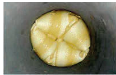
Reversion des Gewebeslauchs: Die Klebstoffbenetzte Innenseite des Gewebeslauchs wird druckunterstützt umgekrempelt und kommt mit der Rohrrinnenwand in Kontakt
