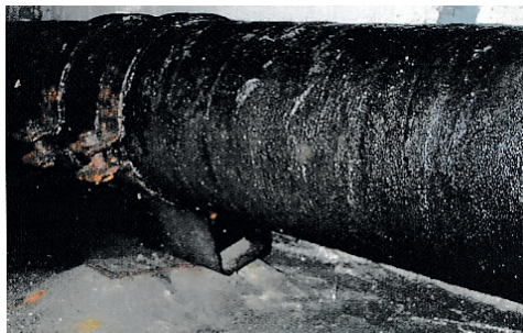
Zustand der alten Leitungen
