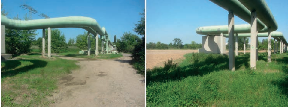
Abb. 8.45: Halle-Neustadt - Fernwärmeleitung im Saaleabflussgebiet nach Saalehochwasser 2013
