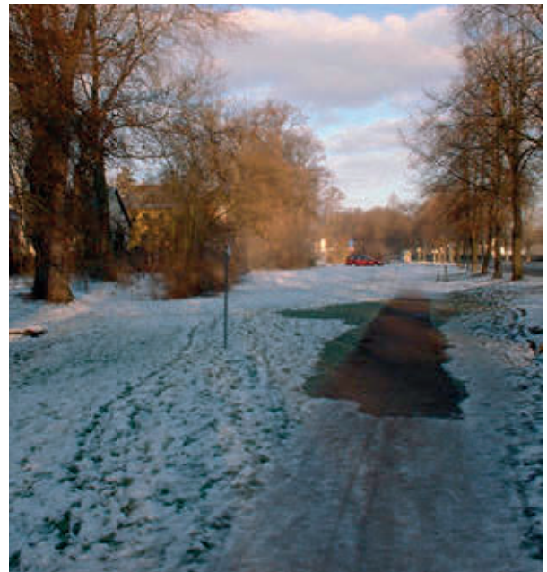
Abb. 4.51: Schadensstelle (Vernässung durch Schaden im Winter gut erkennbar)
