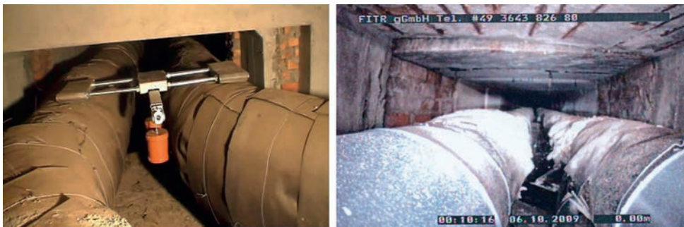
Abb. 8.48: Kanalinspektionskamera (links), Schadensbild (rechts)
