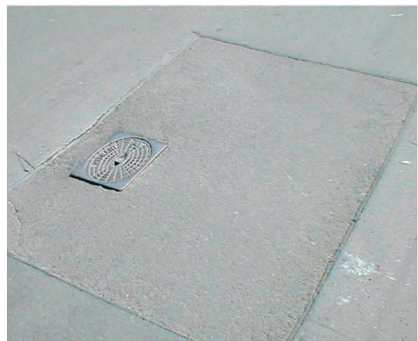
Abb. 1.29: „Flickstelle“ nach Austausch eines Hydranten
