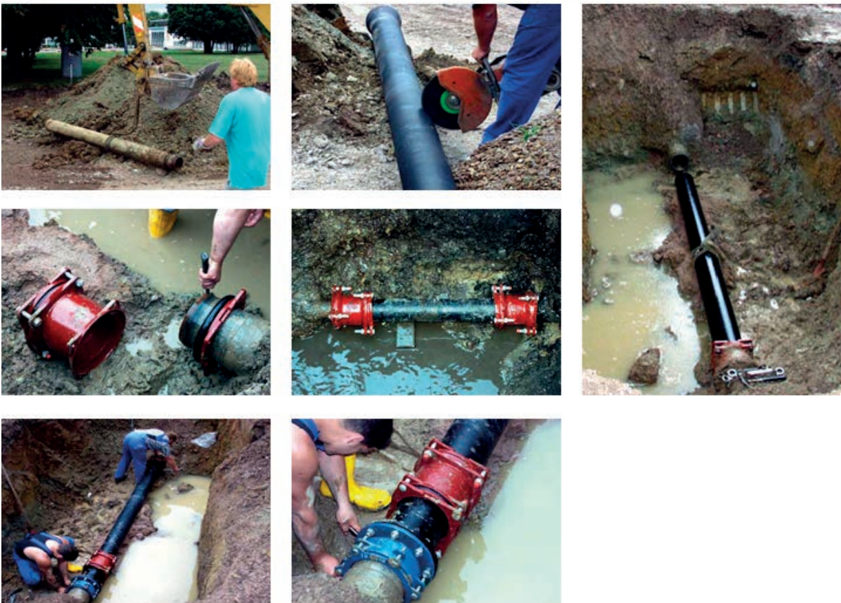
Abb. 4.28: Schadensstelle und Schadensbeseitigung mit Rohrkupplungen
