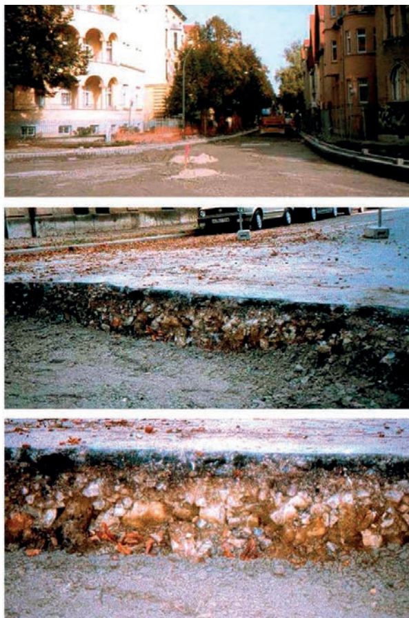
Abb. 1.18: Straßen-Neuaufbau nach Armaturenwechsel – Unzureichender Unterbau der alten Straßenkonstruktion
