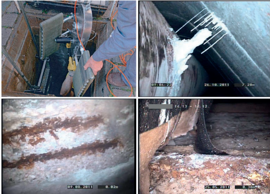
Abb. 8.50: Einsetzen des Gerätes in einen Schacht und Schadensbilder
