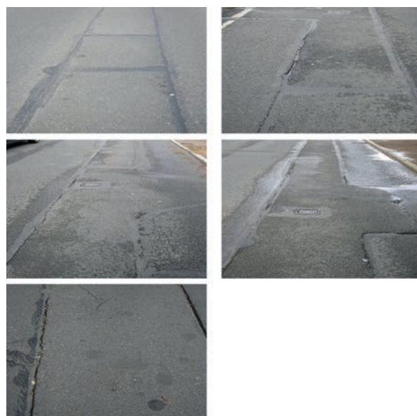
Abb. 1.13: Straßenschäden nach Längsverlegung einer Gasleitung in einer stark befahrenen Stadtstraße
