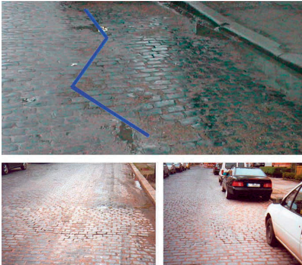
Abb. 1.17: Straßenschäden nach kurzer Liegezeit des Pflasters
