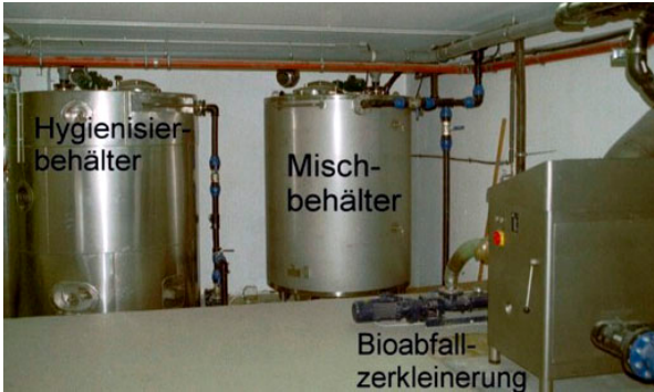
Abb. 7.27: Misch- und Hygienisierungsbehälter der Biogasanlage der Wohnsiedlung Flintenbreite in Lübeck (Foto Oldenburg)
