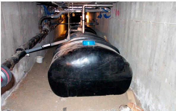
Abb. 7.23: Urinspeicher Wohnkomplex Gebers bei Stockholm (Foto Oldenburg)
