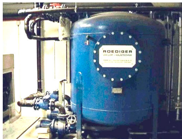
Abb. 7.26: Zentrale Vakuumanlage der Wohnsiedlung Flintenbreite in Lübeck (Foto Oldenburg)
