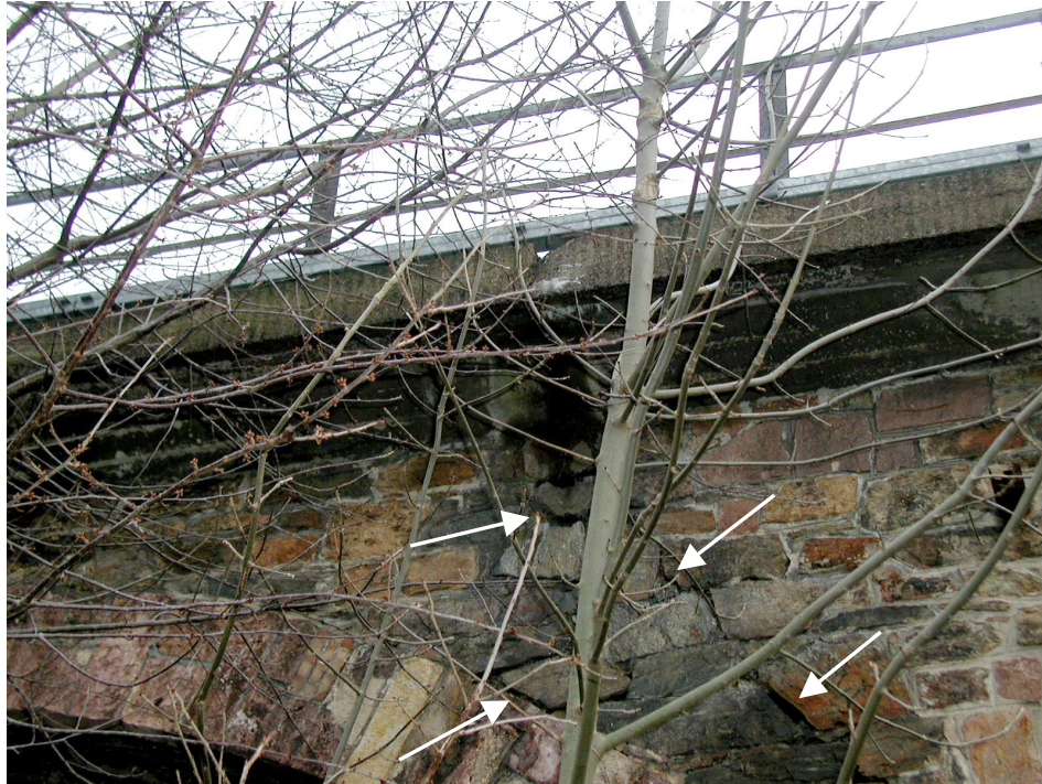
Bild 7.8 Typisches Rissbild in der Übermauerung
