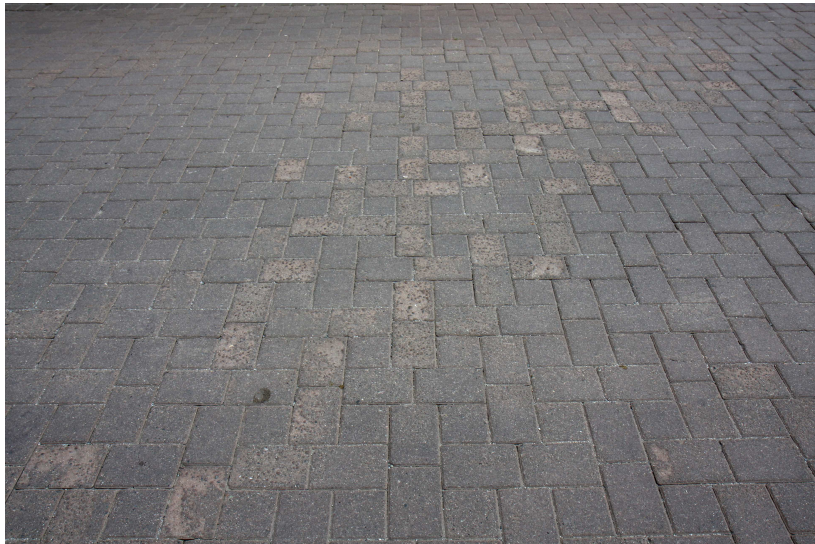
Abbildung 1.3: Unterschiedliche Abwitterungen bei Betonpflastersteinen
