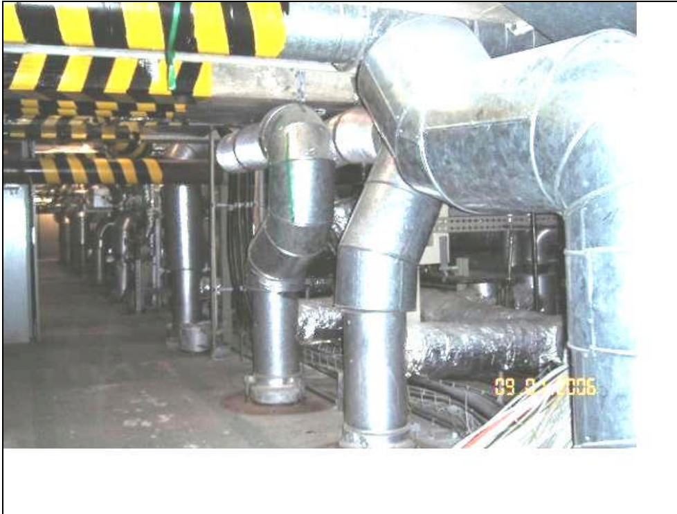
Abbildung 3.2.1/3: Installationsgeschoss über einer OP-Abteilung – Deckendurchführungen (Universitätsklinik Münster, Zentralklinikum, Ebene 04)
