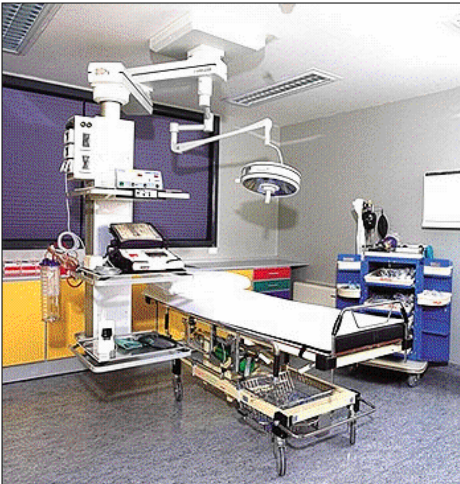
Abbildung 3.2.2.1/5: OP-Feldleuchte im Einbauzustand
