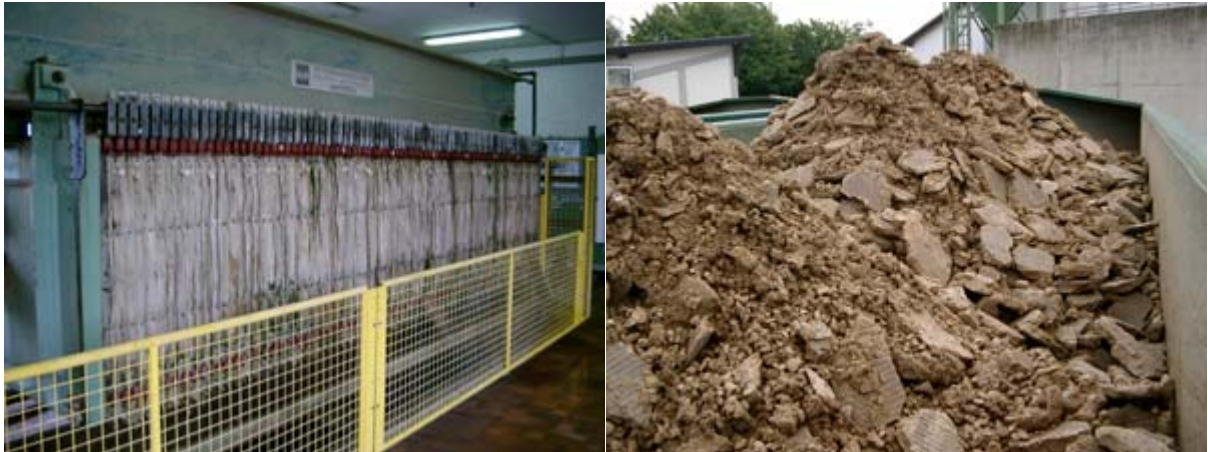
Abbildung 5: Kammerfilterpresse, entwässerter Schlamm
