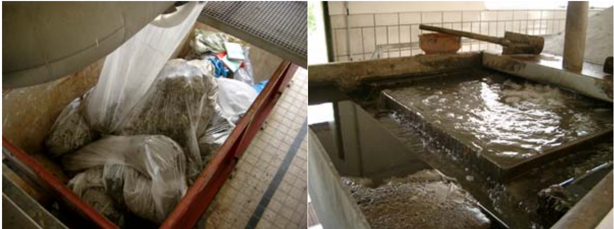
Abbildung 2: Rechengutpresse, Sand- und Fettfangbecken
